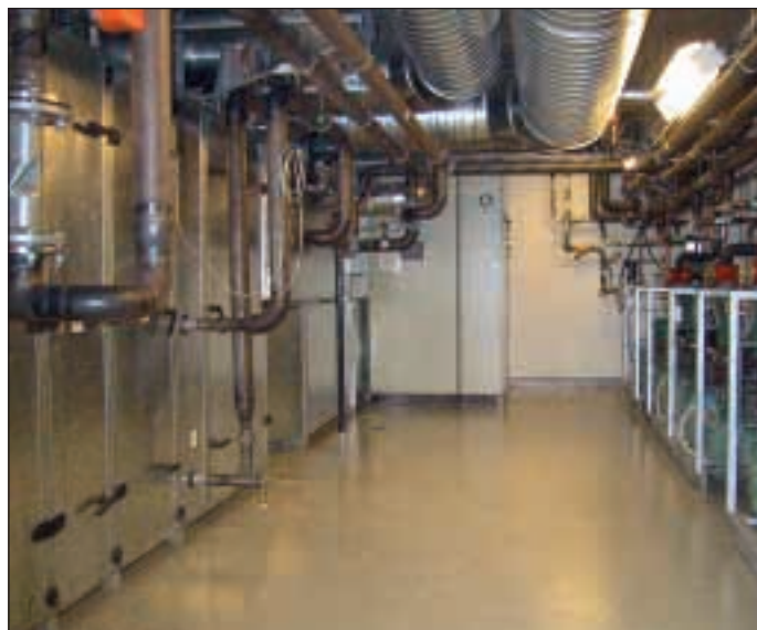
Her er et eksempel på hvordan et teknisk rom bør se ut. Dette er fra en annen Prix butikk under ombygning på Stakkvolla i Tromsø.
