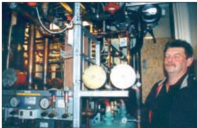
Problemet ved svært mange ombygninger, er at det er dårlig med plass i de tekniske rom og hele anlegget blir derfor meget kompakt med de ulemper dette medfører, sier Tor Vangberg prosjektleder ved ombyggingen
