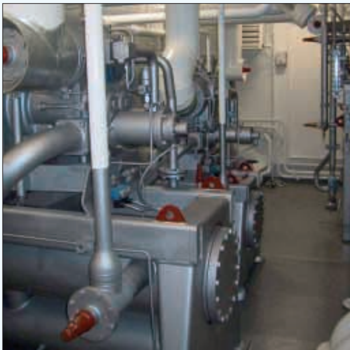
Maskinrommet for kuldeanlegget i en moderne fiskebåt.
