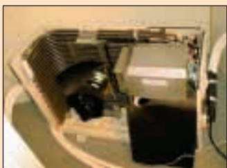
Figur 2 Kompressor er av japansk fabrikat og godt beskyttet med isol. lydmatter
