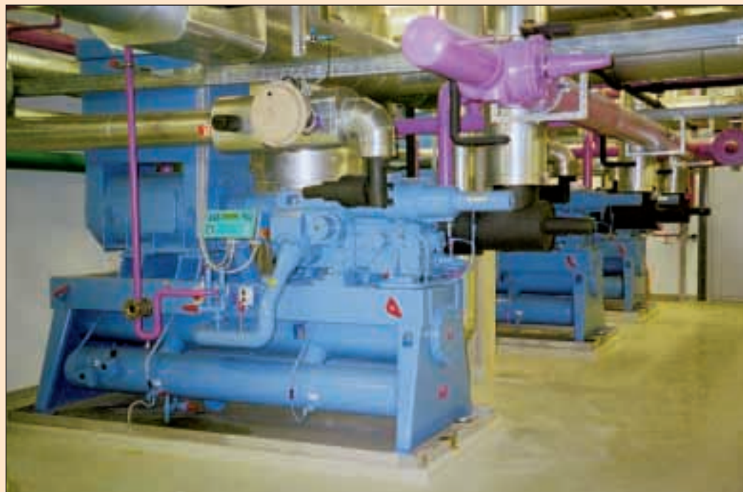
Et maskinrom for NH 3 -anlegg
