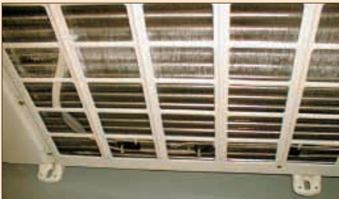
Figur 3 Varmekabelen som skal hindre nedising av dryppannen er montert kun på varmeveksler og vil derfor ikke ha effekt
