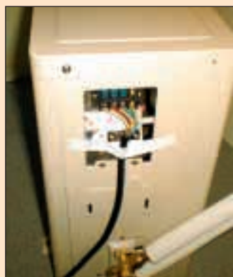
Figur 6 Kompressor er av japansk fabrikk CR06 0137H 003AA og beskyttet med en enkel isolerende lydmatte
