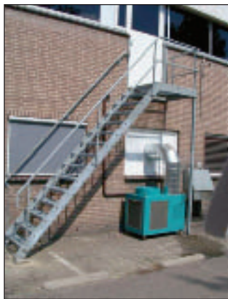
Et mobilt kjøleanlegg kan være en redningen i krisesituasjoner med ekstreme varmebølger, ved sviktende tekniske anlegg og lignende
