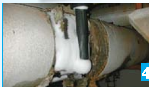
Rörskålar och isolering mot låga temperaturer
