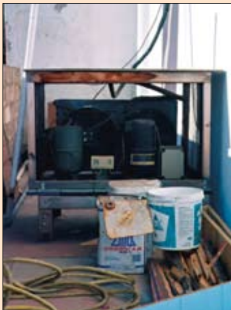
Kjøleanleggene går for lut og kaldt vann mange steder. Ingen beskyttelse og plassert på de underligste steder. Rustne og ustelte kjøleanlegg er et vanlig syn.
