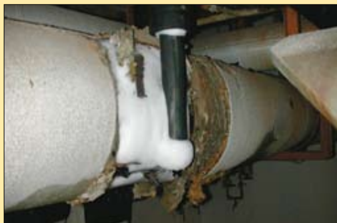
Fig 2: Is på utrustning – från början fungerar isoleringen perfekt men sedan utrustningen har varit i drift en tid, så bildas kondens eller till och med is. Här har ytskiktet splittrats pga inre isbildning.
