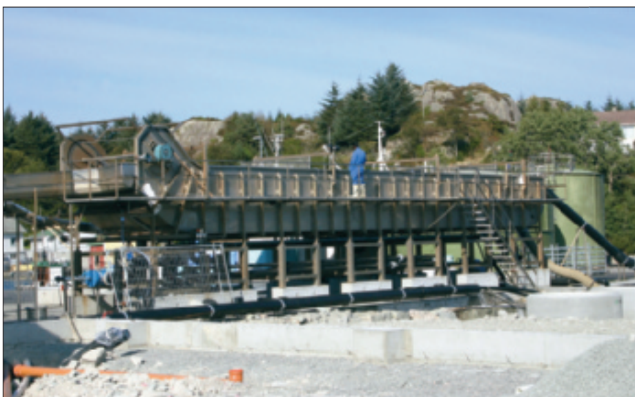
Forkjølingsanlegget hvor laksen kjøles med sjøvann av 6 til 8 grader hentet fra 90 meters dyp.
