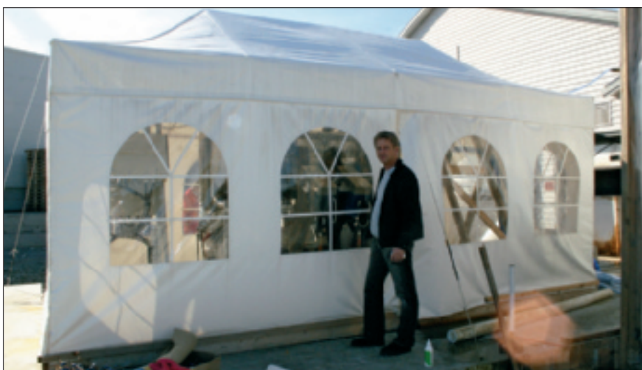
Det nye flow-ice anlegget bygges opp ute under partytelt før vegger og tak settes opp rundt anlegget. Prosjektingeniør Torstein Sævareide fra Skogland AS i Haugesund er ansvarlig for det nye anlegget.
