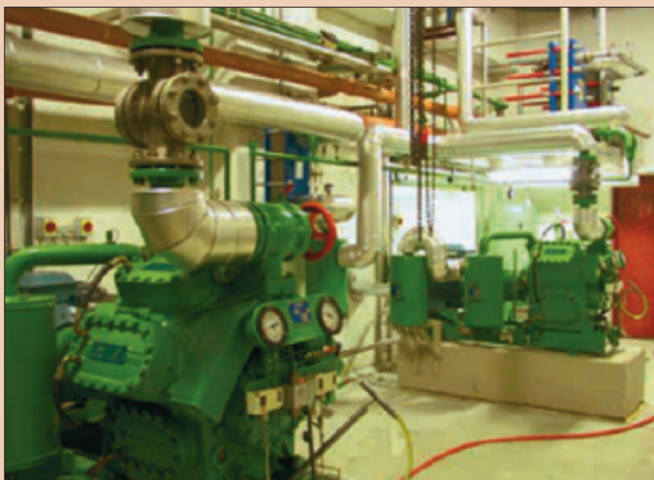
To trinns hybrid varmepumpe ved TINE, Nærbø (kompresjon/absorpsjon).
