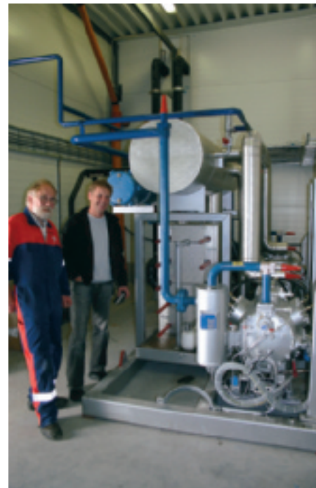
Maskinrommet med et tradisjonelt ammoniakkanlegg fra York. Til venstre driftssjef Tore Tverderøy og prosjektingeniør Torstein Sævereide.
