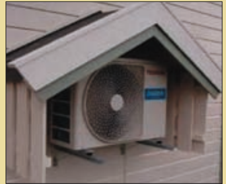
Eget hus t for å beskytte varmepumpene mot vær og vind. Hovedsakelig snø og frost.
