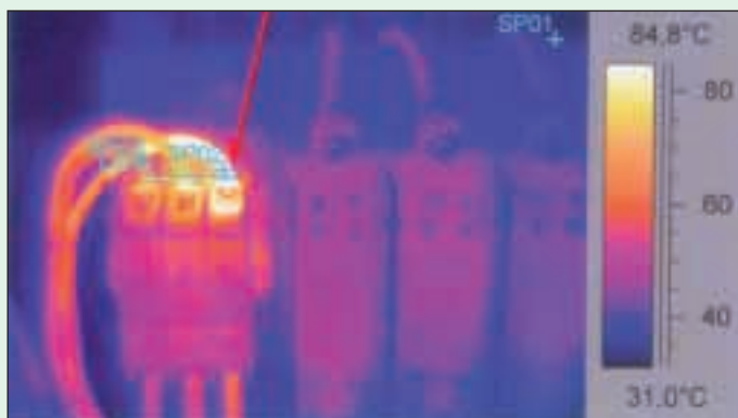
Termografibildet giver klar besked om at kontakten bør udbedres omgående. Da der er en varmeudvikling ved denne forbindelse. Klemmen må kontrolleres for defekter og der bør renses og efterspændes
