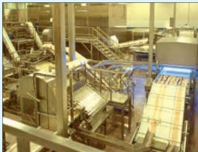
I produksjonshallen er alt i rustfritt stål
