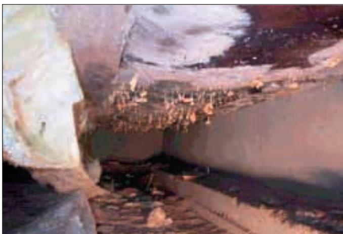
Svampevækst i krybekælder forårsaget af for høj og ukontrolleret luftfugtighed
