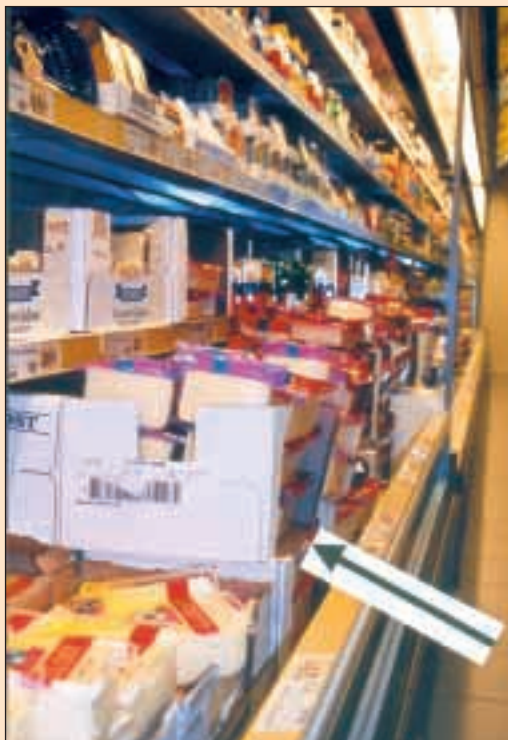
En vanlig feil i kjøledisker er feil stabling hvor luftstrømmen brytes som vist på bildet
