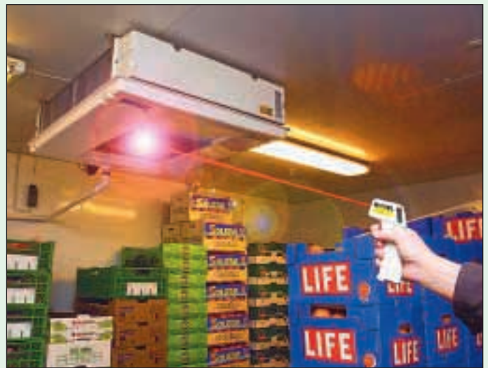
Måling av kjøleanlegg
