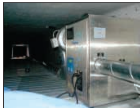
Affugtningsløsning ved kølerum
