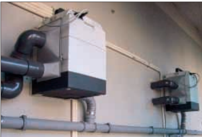
To affugtere installeret over fryserummet forhindrer kondensdannelser.
