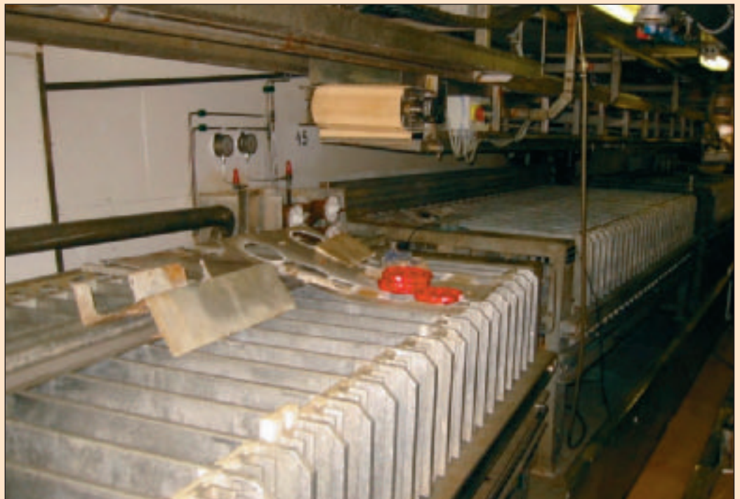
Fra fabrikkdekket på tråleren Sevryba I med to platefrysere. Merk at isolasjonen er fjernet for de to rustne avtegningsventilene. Her hadde skiftet mellom kulde og varme under avrimingen resultert i at skumisolasjonen på grunn av ekspansjonen hadde blitt trykket sammen slik at det var blitt en åpning mellom ventiler og isolasjon. Dette hadde til følge at det hadde dan-net seg kondens som igjen hadde ført til rust.
