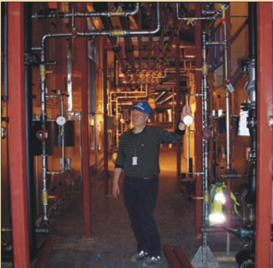
Det var lite å si på rør- og kanalføringene i et bygg uten rett vinkler og stort sett bare krumme flater.
