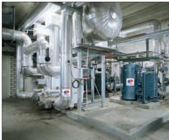
Maskinrommet for alpinanlegget i Bottrop med to skruekompressorer for \text{NH}_3 , fra Axima Refrigeration GmbH
