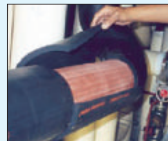
Ingen tegn til rust etter å ha vært isolert med Armaflex i 25 år (anlegg i Rabobank i Utrecht, Nederland)
