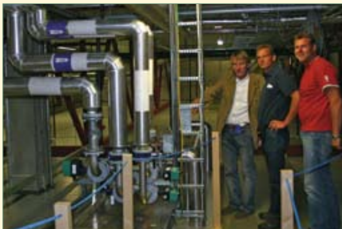
Helge Lunde (t.v.) er konsulent for kjøle og fryseanleggene. Her er man inne på det tekniske loftet over hele bygningen. Med denne løsningen kan man utbedre og fornye anleggene i et behagelig klima, mens prosessen foregår for fullt.
