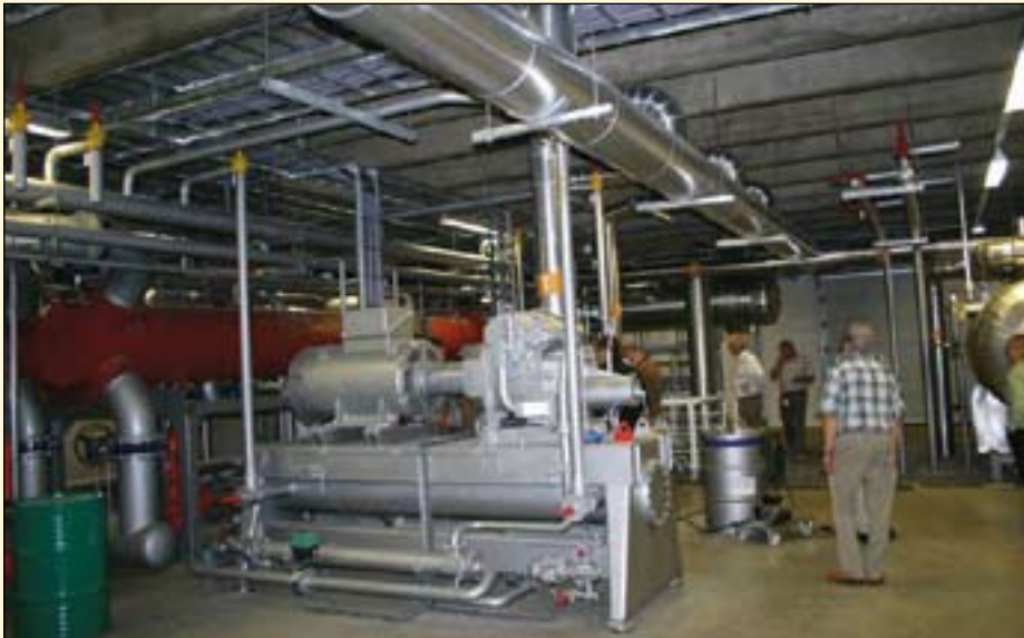
Fra maskinrommet med to CO 2 skruekompressorer og to CO 2 stempelkompressorer for fryserommene. For kjølerommene er en NH 3 kompressor og propylenglykol ute i kjølerommene.
