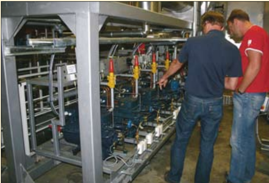
Varmgassavrimingen er ordnet med fire Dorin CO 2 kompressorer. Disse suger gass fra CO 2 kompressorenes trykkside og øker trykket og dermed temperaturen på CO 2 gassen før den går til de fordampere som skal avrimes.
