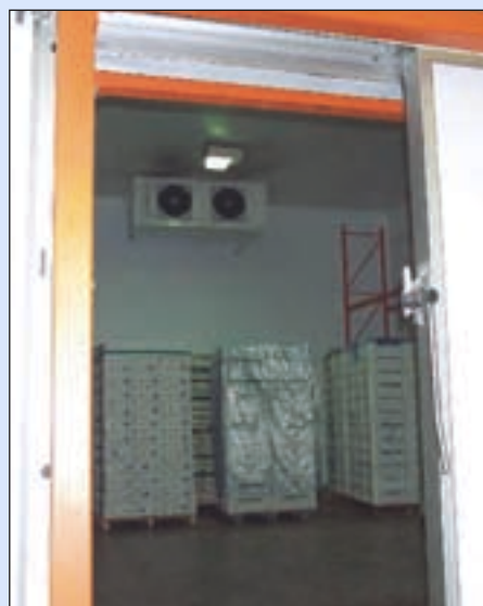
Et stort problem er stadig trafikk inn og ut av fryserommet.
