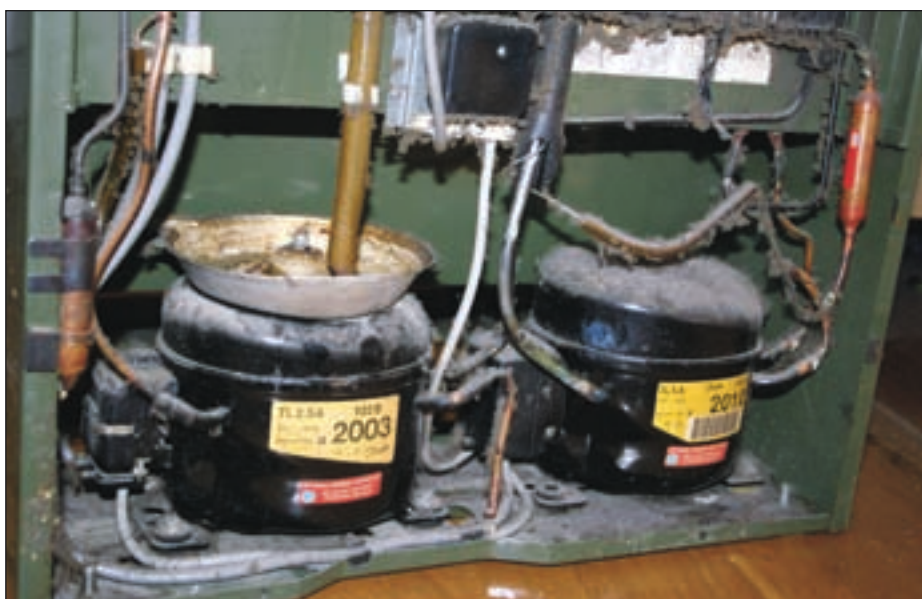
Slik ser det ut bak mange kjøle- og fryseskap.
