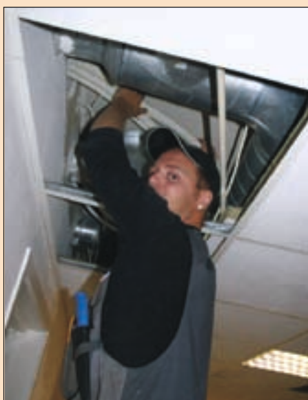
Her får Per Roger Seberg ros for fornuftig og praktisk plassering av kjølerørene.
