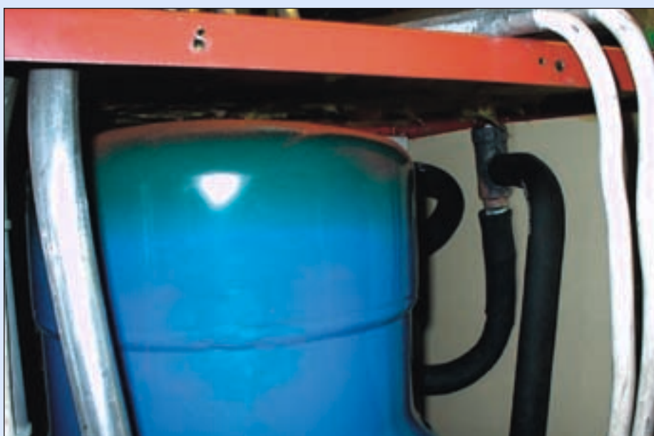
Kompressor missfärgad av otillåtna temperaturer orsakade av felaktig överhettning.
