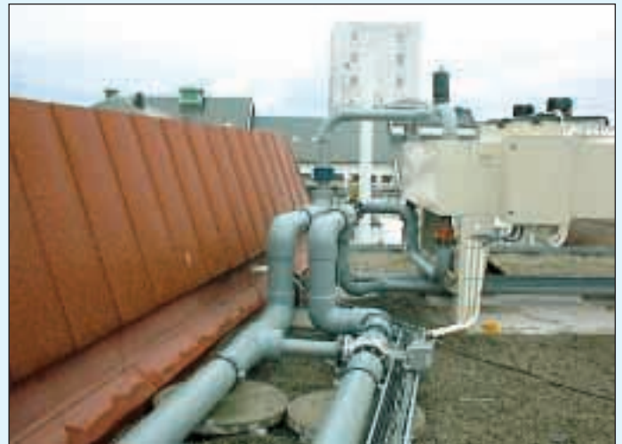
6. Rørstrekket til tørrkjøler på MEGA butikken på Nærbø. Hovedstrekket er d200 .
