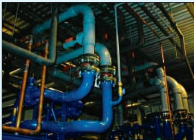
1. Overgang ABS/ stål via flens. Kompensatoren i mellom er for å oppta vibrasjoner
