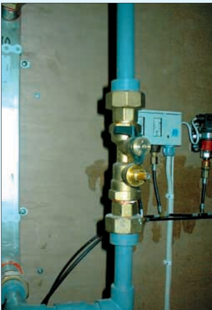
7. Unionen øverst viser overgang mellom ABS og Stål med en union. Alle unionene har o-rings pakning mellom metall del og ABS del. O-ringene tar opp forskjellene i utvidelse/ sammentrekning som er mellom ABS og metallene.
