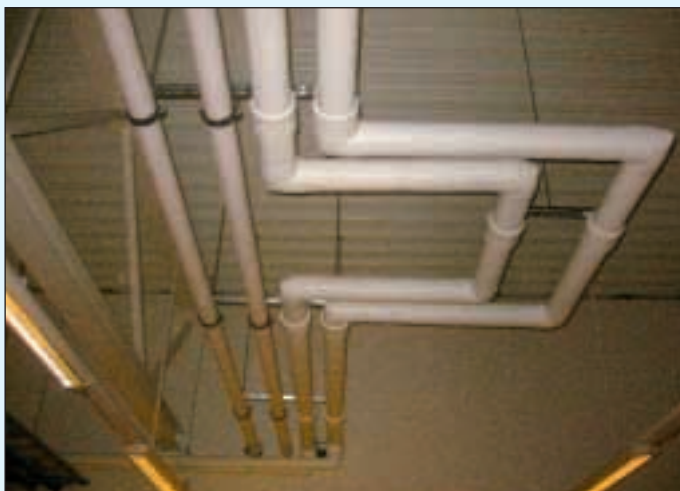
2. Rørføring for å oppta sammentrekning (ekspansjonen) av ABS rør grunnet temperatur. Rørene er isolert med cellegummi som er malt hvitt.
