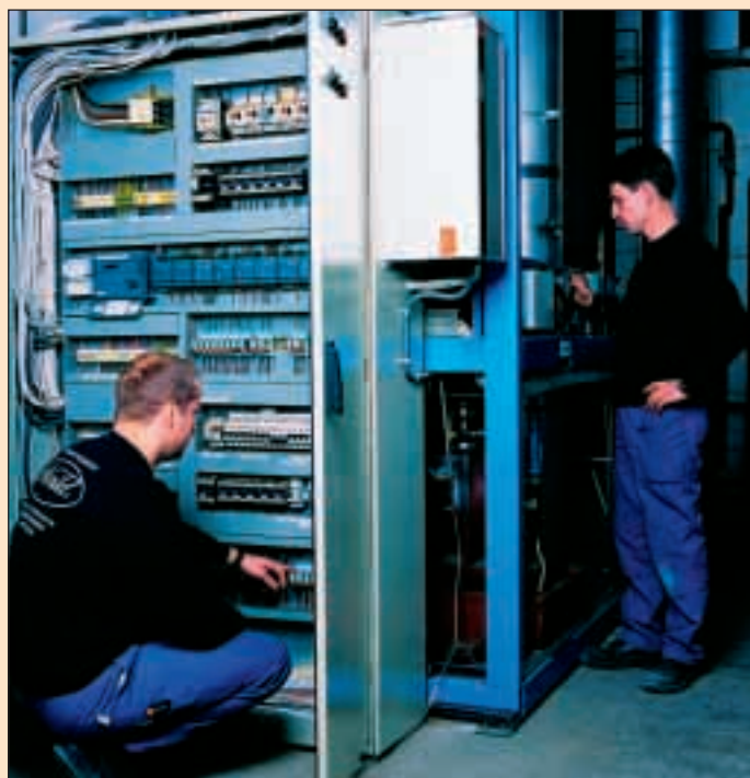
Prototypeanlegget ble bygd opp i et datastyrt laboratorium der man kunne simulere ulike forhold i omgivelsene for kjøle- og frysemøblene som er tilkoblet kuldeanleggene. Et eget fryserom ble også installert for å simulere en virkelig butikk.
