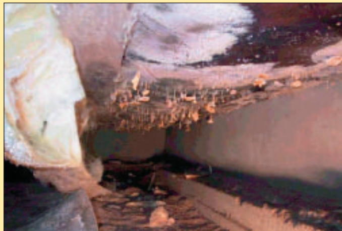
Krybekælder med svamp.
