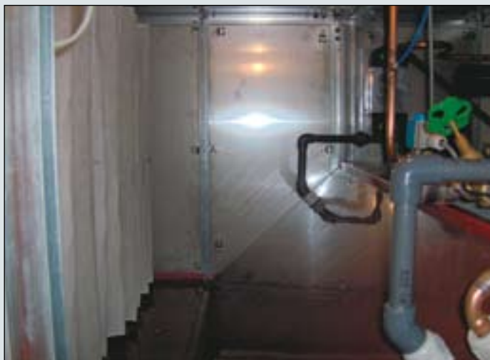
Hele avtrekksveien er i rustfritt stål med avløp i gulv for å lette regelmessig desinfisering.
