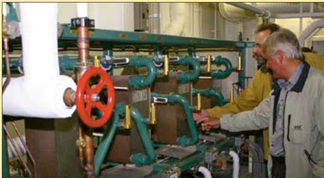
Det er viktig at en kuldemontør bruker alle sanser, både ører, øyne, nese og "håndpåleggelse" når han skal sjekke et kuldeanlegg. Det er også meget viktig at selve maskinrommet er rent og ryddig.
