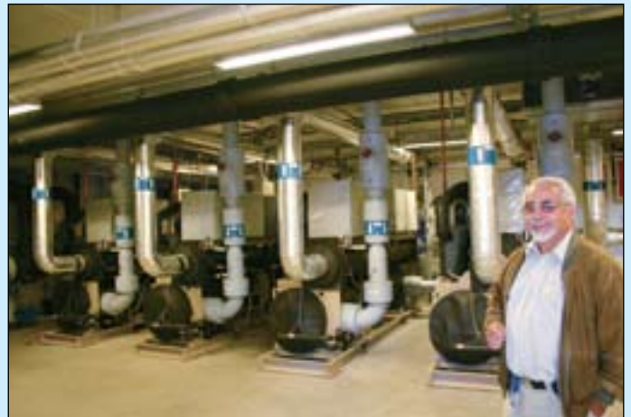
Prosjektleder Oddvar Larsen fra Lyse Energi inne i Lura energisentral for fjernkjøleanlegget med 4 stk kompressorer med en effekt på 500 kW hver. Det er også avsatt plass til to nye kompressorer på 500 kW.
