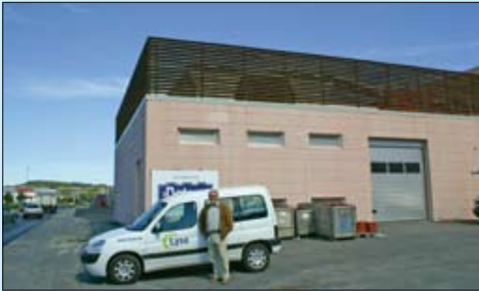
Lura energisentral for fjernkjøling av Forus industrierområde nær Stavanger har tørrkjølere diskret plassert på taket uten at de skjemma bygningsutformingen. Merk gitterveggene som gir god luft-gjennomstrømning rundt tørrkjølerne og dermed god kjøleeffekt.
