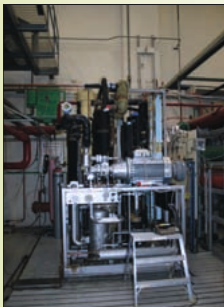
Småskala LNG anlegg med kapasitet på ca 1000 kg/dag utviklet av Professor Einar Brendeng kan bli viktig for utviklingen av LNG i Norge. Anlegget er utviklet av standard komponenter noe som gjør det rimelig.
