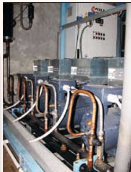
Den største utfordringen for CO 2 -kjølesystemet i Australia ligger i det varme klimaet. Det gjelder å ta hensyn til utetemperaturer som av og til kan ligge over 40° C. Disse forhindrer kondenseringen da CO 2 overskriver sitt kritiske punkt ved 31° C. For å løse dette problemet ble det koplet en fordampningskjøler foran den luftkjølte kondensatoren. Når omgivelsestemperaturen stiger over 28° C, kjøler denne ned luftstrømmen som strømmer inn i kondensatoren.
