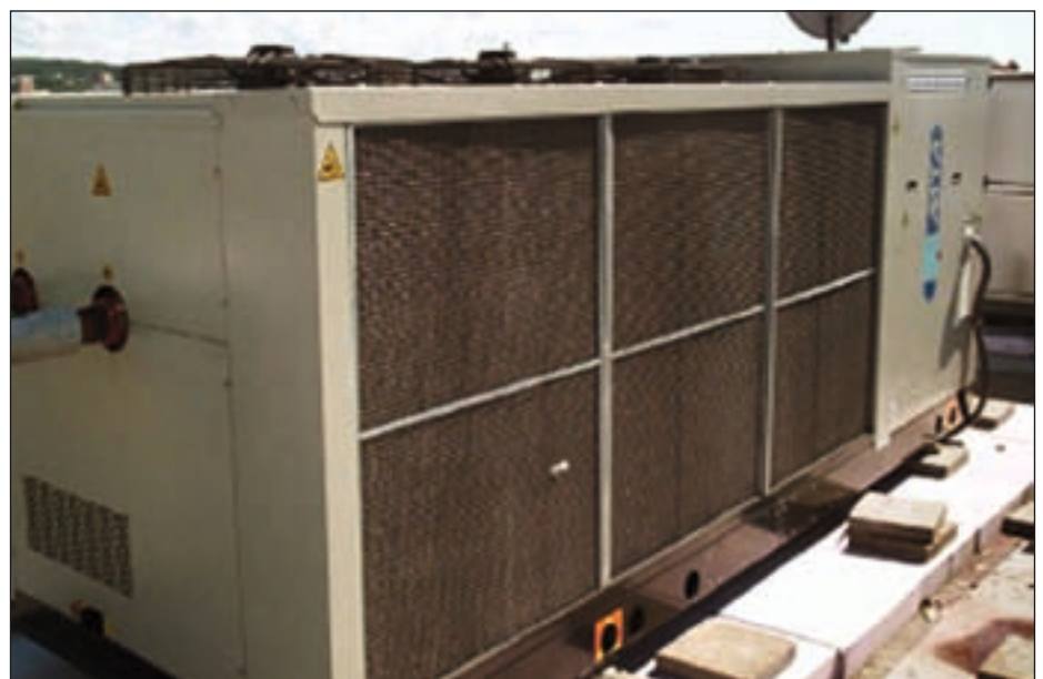
Merk opplagringen mot taket
