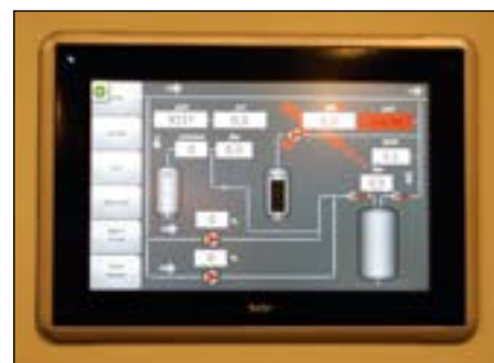
Fra denne skjermen styres og overvåkes det nye Niprox-anlegget for behandling av teknisk vann.
