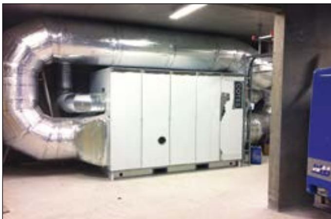
Avfukteren i Fosenhallen håndterer 18.000 m 3 luft i timen når den går for fullt. Foto: Fosen Ventilasjon.
