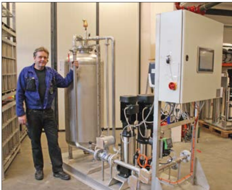
Niprox teknisk direktør Inge Ellingsund med det nye avanserte vannbehandlingssystemet til fjernkjølenettet i Fours i Stavanger.
