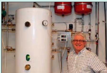
Thore Syd tangen i cTc FerroFil med den nye bereder og akkumulatortanken.
