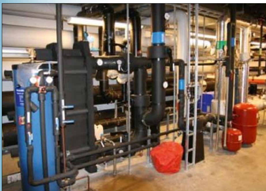
Undersentral varme- og kjøling i E0.
