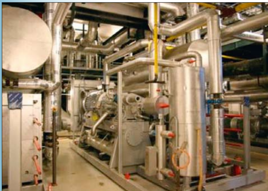
Det er 4 stk varmepumpeaggregat i teknisk sentral.
