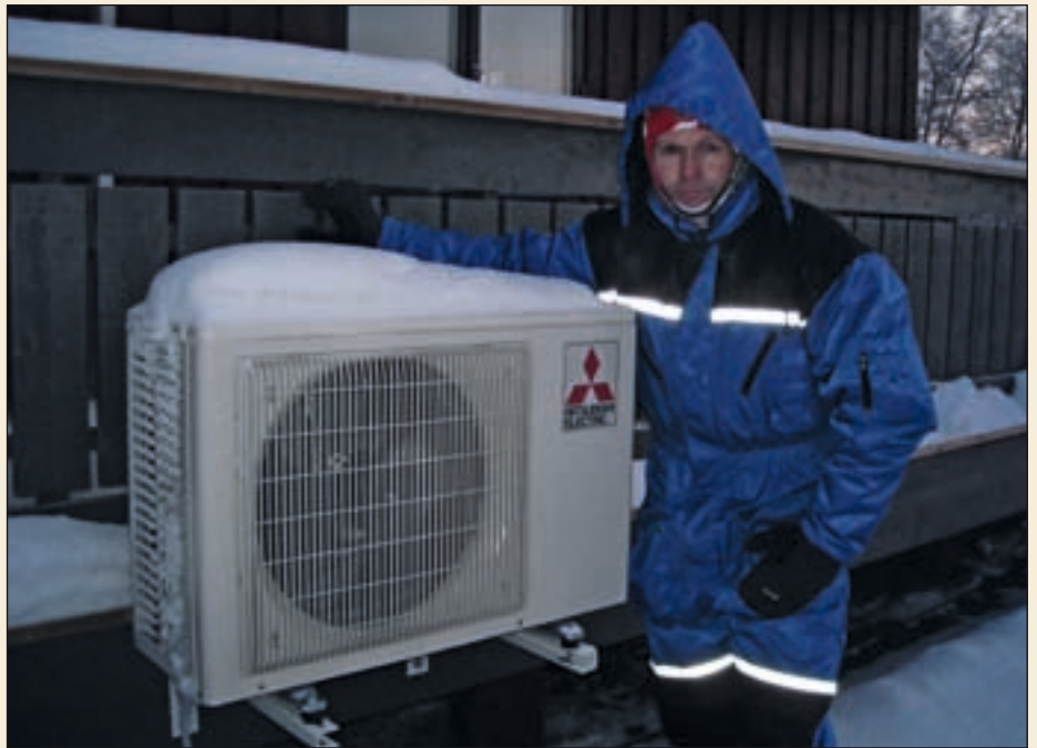
Forhandler av Mitsubishi Electric varmepumper på Røros, Geir Riddervold i Røros Varme kan melde om svært kalde dager for varmepumpene.
