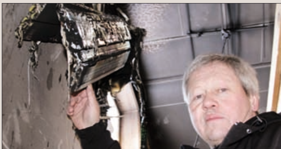
Atle Ganderudbakken i Byrkjelo fikk reddet både hus og garasje da varmepumpa tok fyr.
