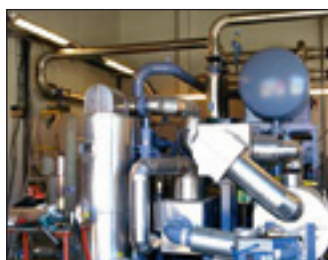
18. Fjernvarmeanleggene får flere varmepumper
