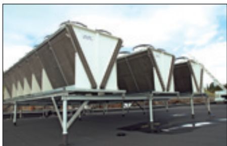
Kondensatorene på taket.
