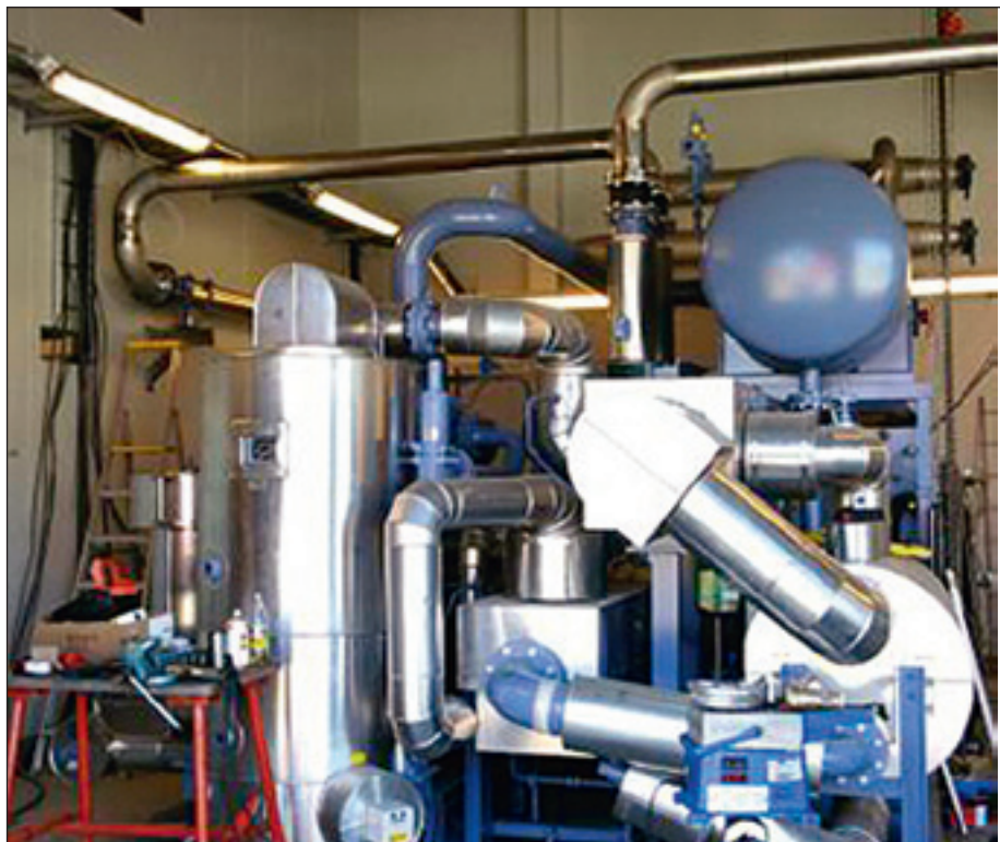
Varmepumpa som i disse dager er installert i fjernvarmeanlegget i Sarpsborg er på 2 MW og har ammoniakk som kuldemedium.
