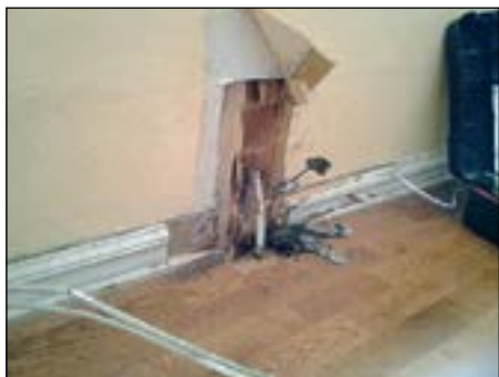
Brannvesenet måtte fjerne varmepumpen og bryte opp veggen for å fjerne ulmebrannen i stikkkontakten.
