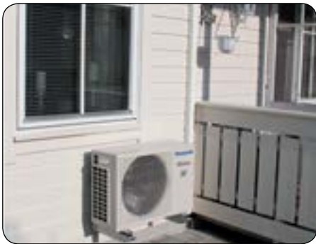
Varmepumper bør ikke placeres på facaden.
