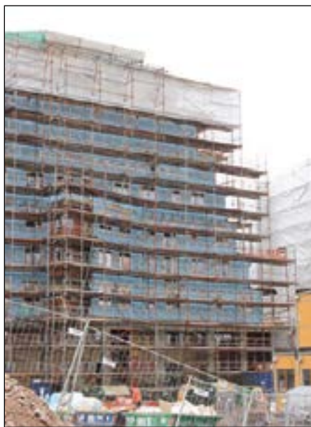
(NW): Yrkesbygg renoveres dessverre ofte uten at det er satt konkrete energimål, viser en ny undersøkelse.
