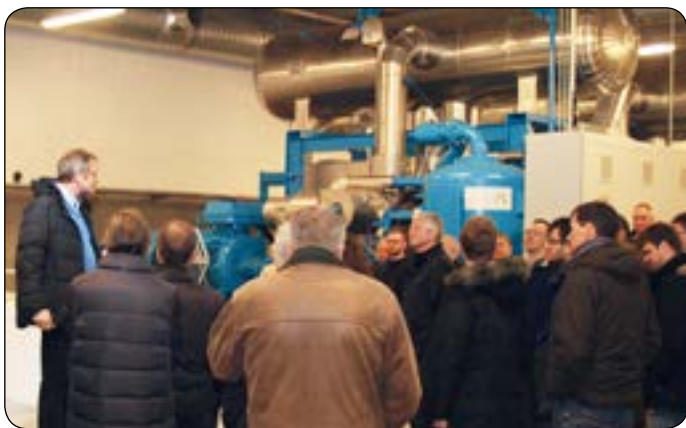
Ved besøget i fjernkølingscentralen blev deltagerne vist rundt af Cowi A/S med forklaring på de forskellige dele som fjernkølingscentralen består af - Se billedet nedenfor. Foto: Eigil Nielsen
