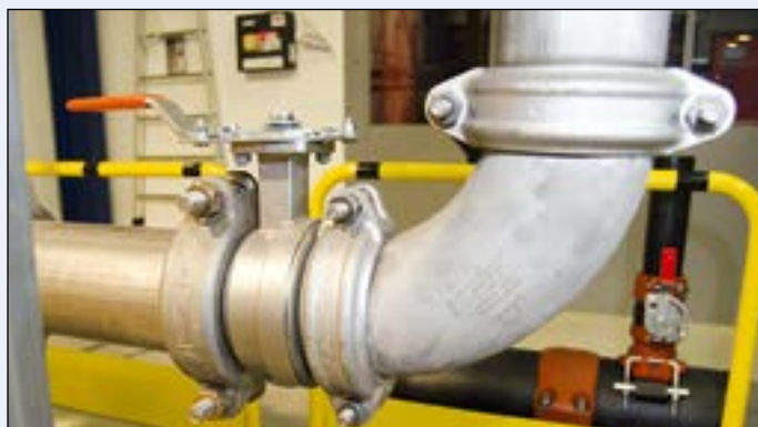
Nordviken er et boligområde i Hamar hvor rørleggerfirmaet Ing. Øyvind Pedersen AS fra Elverum benyttet de nye produktene i en boligblokk, både på sprinkler og varme/kjøling.
