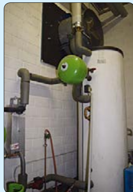
Figur 2 varmegjenvinner producerer varmt vand for sanitært brug.
