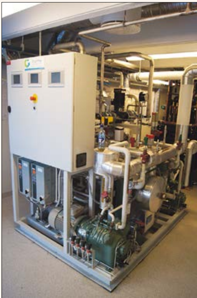
Nytt tottrinns NH 3 -anlegg levert av Therma AS.
