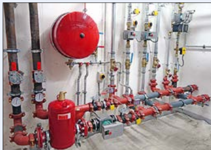
Fra under bygging av Ål Helsetun, utført av Bærums Verk rørleggerbedrift, hvor de benyttet Victaulic til sprinkler, varme og kjøling. Dette var det første prosjektet i Norge hvor systemet «Strengthin100» er benyttet.
