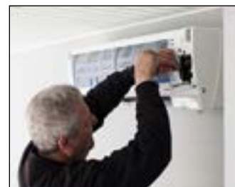
30 Stadig flere skifter til ny varmepumpe
