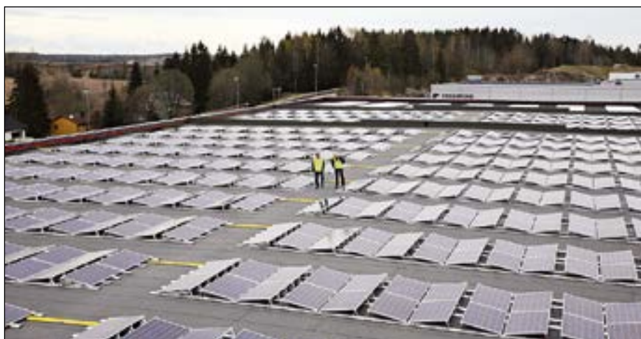
På taket av Norges største fryseboks er det nylig montert 2588 solcellepanel. Installasjonen nær tredobler det som allerede er Norges største solcelleanlegg på Askos lagertak på Vestby. (Foto: Lars Erik Olsen/Asko)
