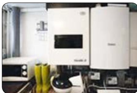
Hybridinstallationen giver en årlig energibesparelse på 8.300 kroner. PR-foto.
