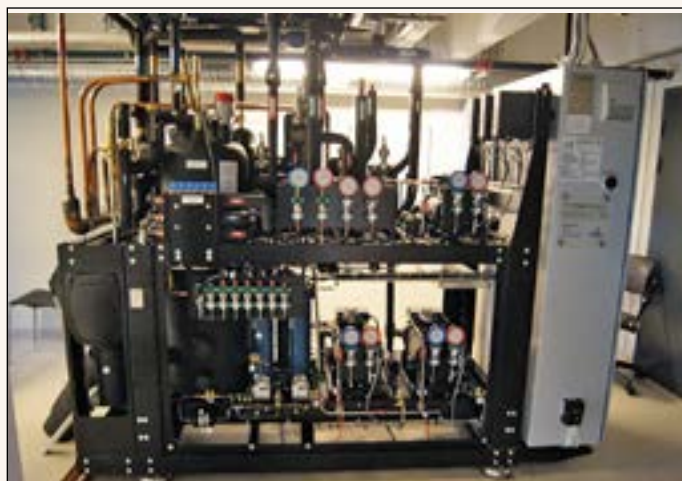
Nytt CO 2 -anlegg levert av Kelvin AS.
