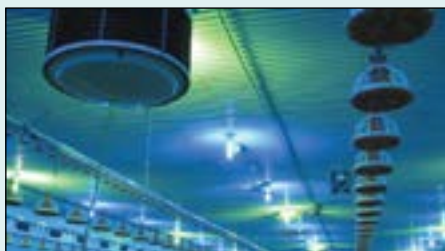
Knut Storrø har laget en egen varmpumpe i kyllingfjøset. Varmepumpa trekker ut varmen i ventilasjonslufta, for så å tilføre denne varmen til gulvvarmesystemet.
