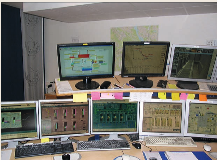
Övervakningscentralen med integrerad ClimaCheck. Foto Olle Dahlberg
