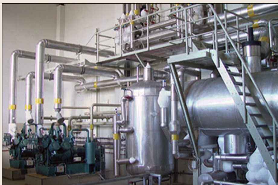
En av installasjonene til Skogland AS.
