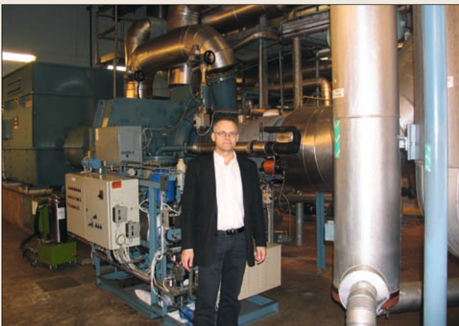
Värmepumpcentralen med Lars Olin. Foto Olle Dahlberg
