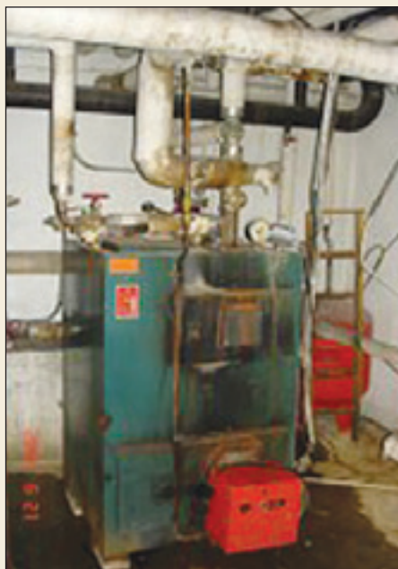
Det blir ingen toppkarakter i energimerkingen med denne kjelen.
