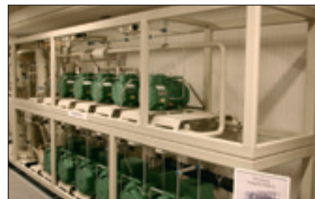
Moderne CO 2 -anlegg for butikkøling.
