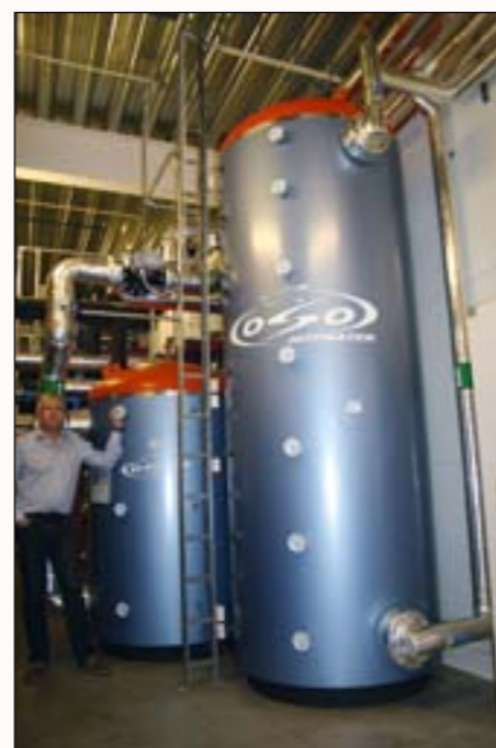
Figur 4 Lagring er viktig når det gjelder å utnytte forskjellige energiformer. Et problem kan være temperaturskitning mellom de forskjellige nivåene i tankene. På dette anlegget har man satt opp hele 7 termometre som viser temperaturfordelingen oppover i tanken. Dette noe man snakker om, men sjelden får se.
