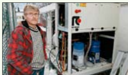
- Hærverket på varmpumpe ved Høyanger kyrkje har ein prislapp på om lag 115.000 kroner, seier kyrkjevevjerje Bjarne Bjørnar Otterstein. Foto:Geir Ivar L. Ramsli
