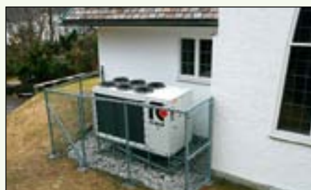
Varmepumppa ved Høyanger kyrkje. Foto:Geir Ivar L. Ramsli
