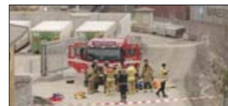
Brann- og redningsetaten sendte inn kjemikaliedykkere for å stoppe en ammoniakklekkasje fra en varmepumpe i kloakkrenseanlegget inne i fjellet.
