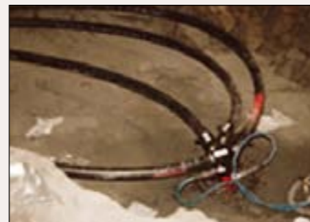
På bildet ser man hvordan fire kollectorslanger er koblet sammen på toppen av en energibrønnene på HiB og skaper kontakt mellom berggrunnen og varmepumpene.
