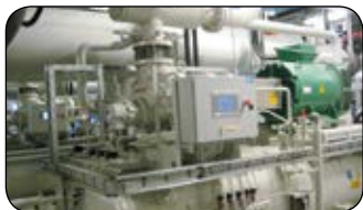
77 Store varmepumper kan gøre spildvarme til grøn fjernvarme
