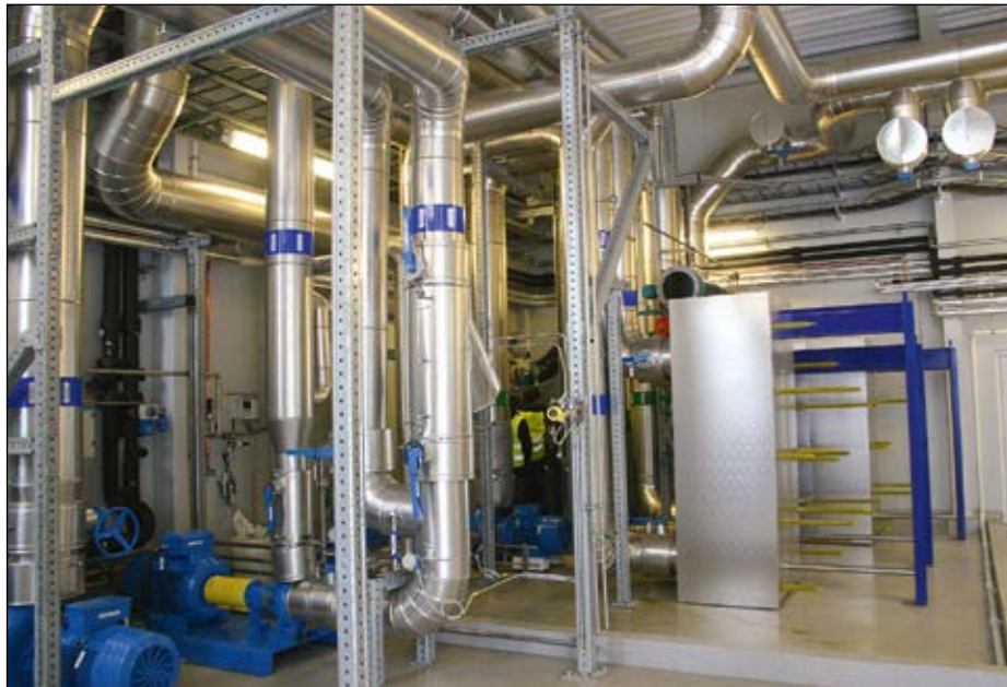
Den delikate varmesentralen i Horten med sjøvannsvarmepumper med ammoniakk.
