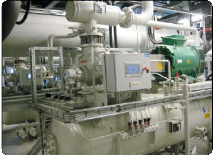
Industriell varmepumpe leveret av Therma i Norge.
