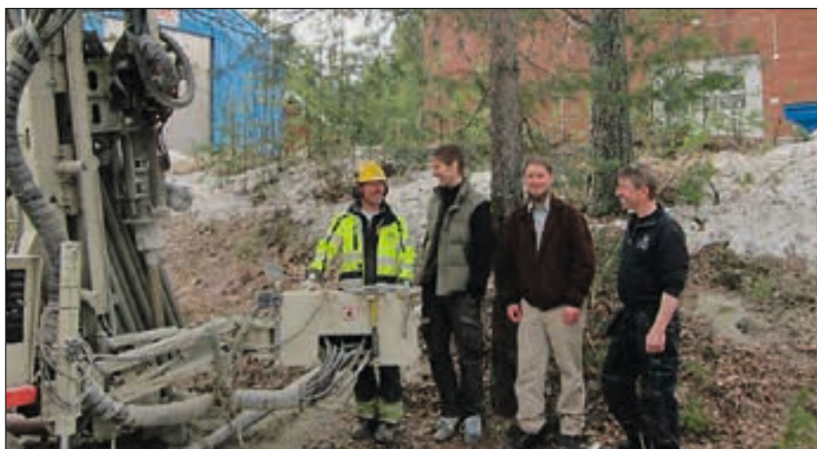
I forbindelse med EPC prosjektet er det bygget 14 bergvarmeanlegg.
