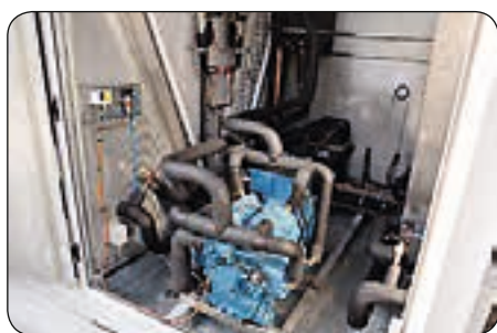
En af Cronborgs 170 kW luft-til-vand-varmepumper opstillet hos Saint Gobain i Randers. Foto: Cronborg
