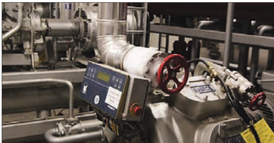
Kjøleanlegg må jevnlig testes for lekkasjer. Foto: Torggrim Asphjell, Miljødirektoratet
