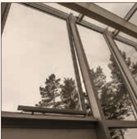
Motorstyrte vinduer høyt på veggen åpnes automatisk når det trengs for å sikre godt inneklima. Om vinteren skjer det i korte pulser. (Foto: Lavenergiprogrammet)
