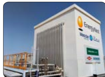
I de internasjonale energimarkedene er det stor etterspørsel etter løsninger som kan sluse fornybar energi inn i kraftnettet etter behov. EnergyNest har utviklet et betongbatteri som nå testes ut ved Masdar Institute of Science and Technology forskningsanlegg for konsentrert solkraft i Abu Dhabi.
