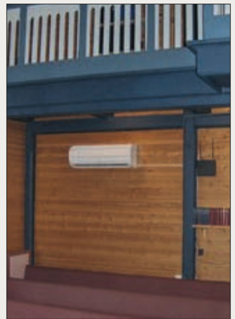
Varmepumpen er plassert bakerst i kirken.
