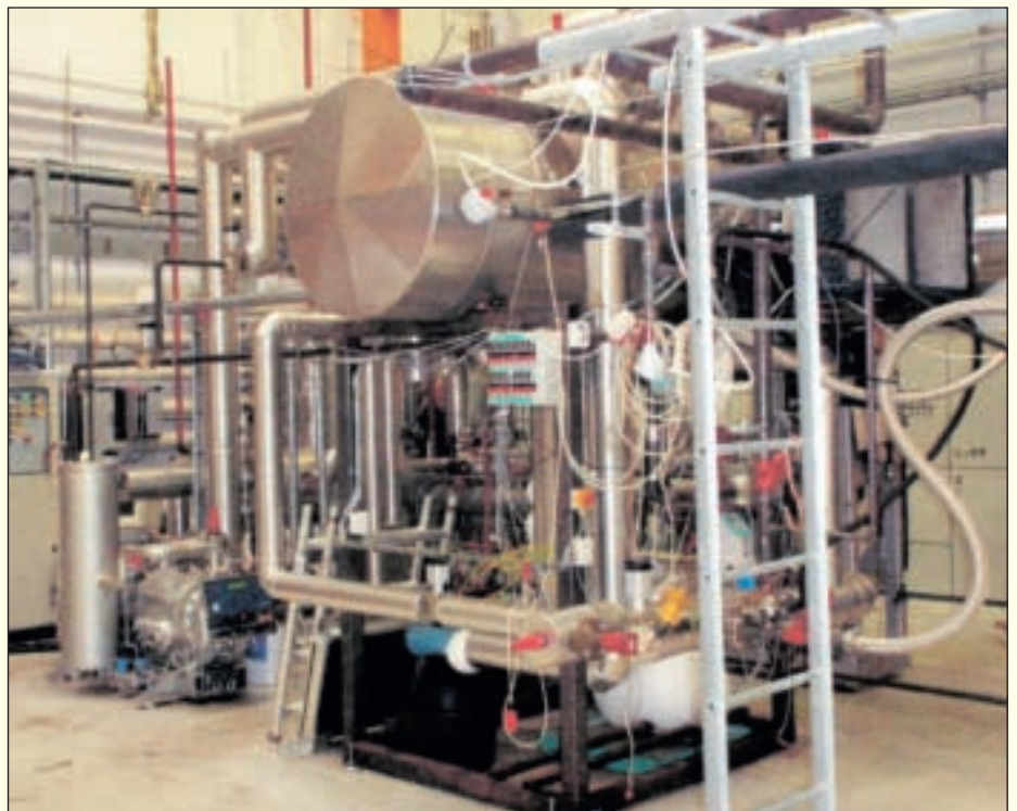
CompFreeze - anlægget i lab.
