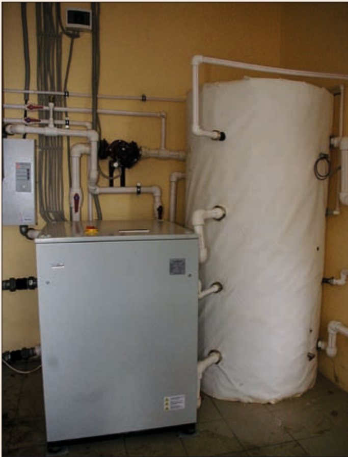
Varmepumpe og akkumuleringstanken i administrasjonsbygningen.
