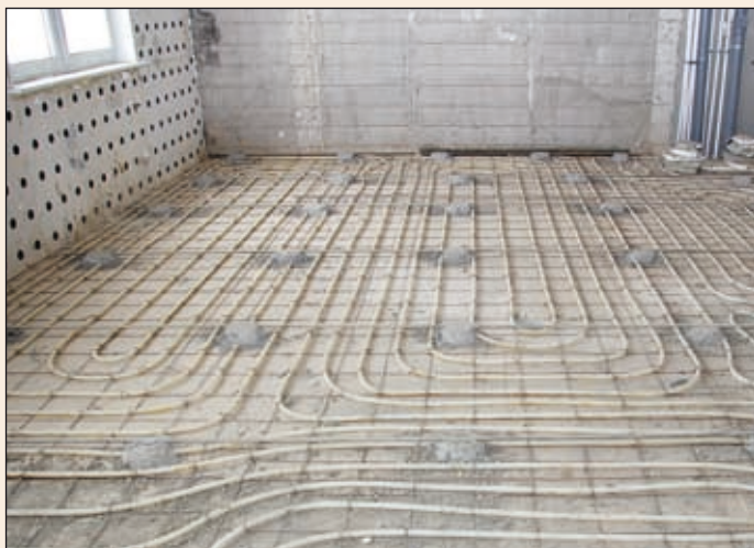
Varmerørene i gulvet. Merk at det er kortere avstand mellom rørene nær vinduene.
