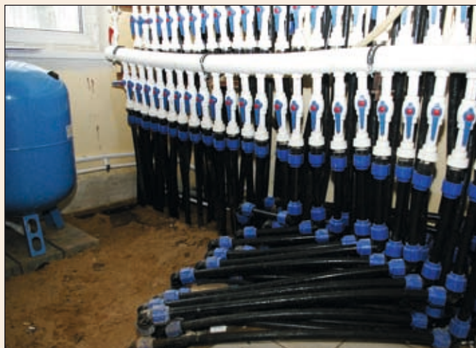
Tilknytningen til varmevekslingsrørene i brønnene for administrasjonsbygget.
