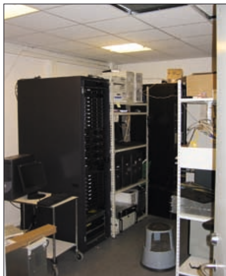
Et serverrum trænger utrolig meget køling. Her et billede fra et ældre serverrum.
