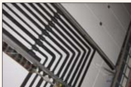
En slik rørføring man kan være stolt av.
