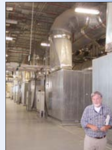
HVAC Technical HVAC Adviser Philippe Walter i den tekniske etasjen på toppen av alle de seks store campus bygningene med enorme airconditionanlegg og doble roterende varmevekslere.
