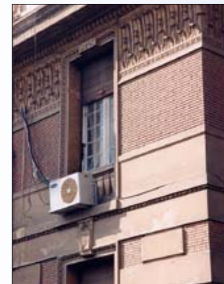
Ledninger og rør henger og slenger på fasadene og skjemper de gamle, vakre fasadene.
