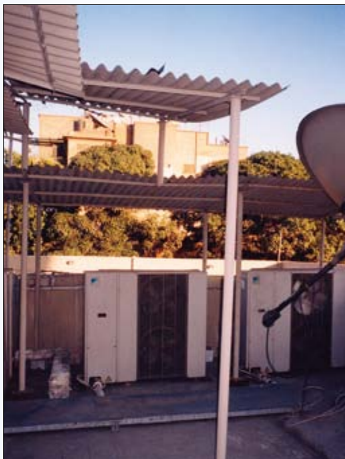
Soltakene man satte opp over kondensatorene for å få ned temperaturene. I bakgrunnen ser man den høye ringmuren rundt tak som gjør at luften på taket blir stillestående og glovarm.
