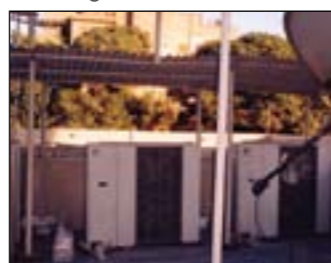
42. Kondensatorer med soltak
