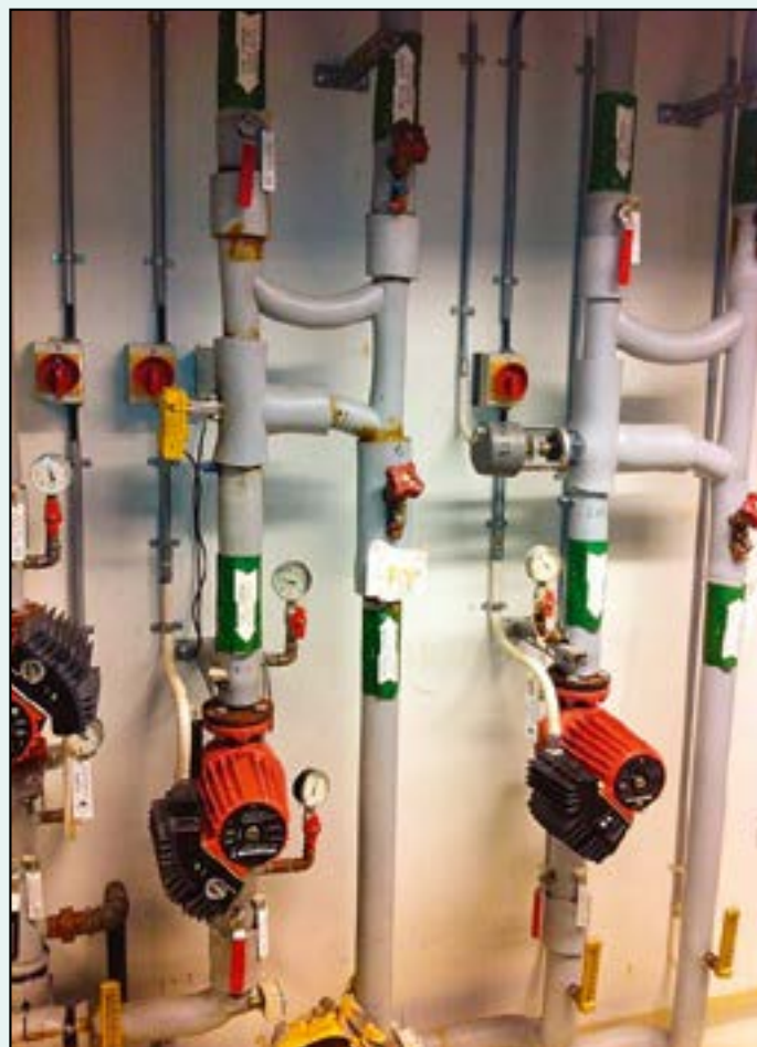
Typisk innkopling av varmelast med system for konstant volumstrøm der tur og retur blandes i shuntkopling øverst i bildet.
