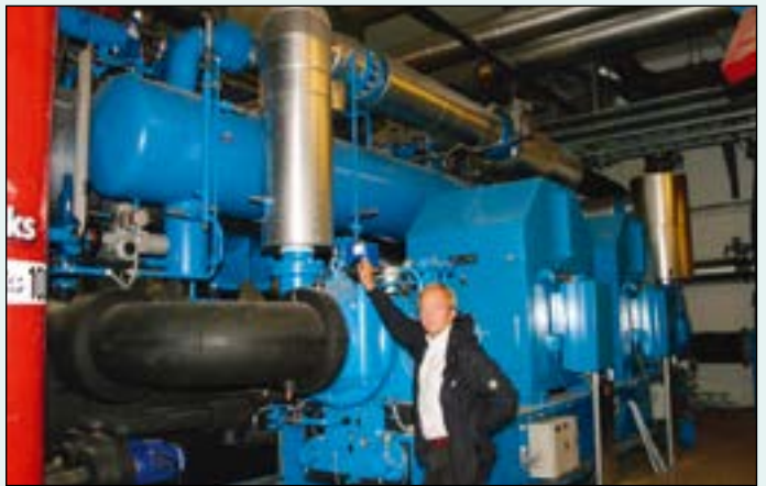
Fortum er den bedriften som har flest store varmpumper. I sju varmesentraler er det i drift store varmpumper. Den største er i Sandvika, med en varmeytelse på 22 MW. Til sammen kan Fortums varmpumper levere 76 MW varme og 70 MW kjøling. Fortums varmpumper bruker både kloakk og sjøvann som varmekilde om vinteren og varmeavtak om sommeren. Bildet viser avdelingsleder Claus Heen i Fortum Fjernvarme.
