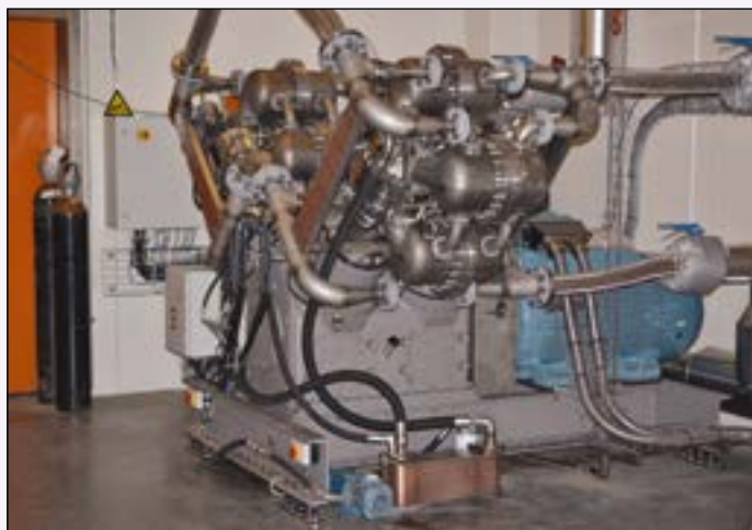
Varmepumpen som ble installert på TINE sitt anlegg i Byrkjelo.
