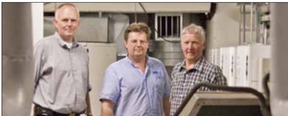
Modum kommunes geoenergianlegg med varmepumper. F.v. teknisk sjef Harald Silseth, Roy Paulsen i Partnerline AS og vedlikeholdsleder Helge Kleiv.
