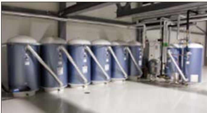
Figur 4 Tre stk gasskjølere på hvert aggregat er installerte i serie.
