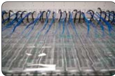
Ved at nedsænke servere i en nyopfundet væske mener 3M at kunne reducere køleudgifter til datacentre med 95 pct.
