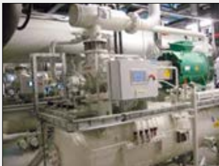
Vi får flere og flere miljøvennlige ammoniakkanlegg både til lands og til vanns.
