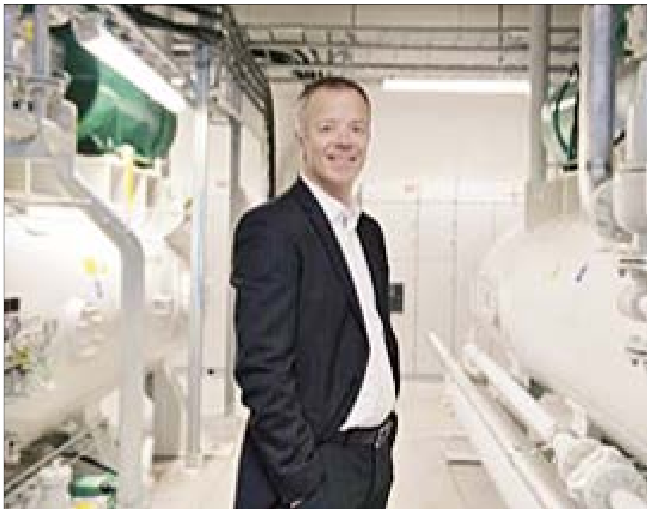
– Vi er glade for å forsyne Nydalen med fornybar energi fra et av de mest komplekse, miljøvennlige og innovative energianlegg i landet, sier forvaltningsdirektør Roy Frivoll i Avantor. Foto: Erik Burås/StudioB13
