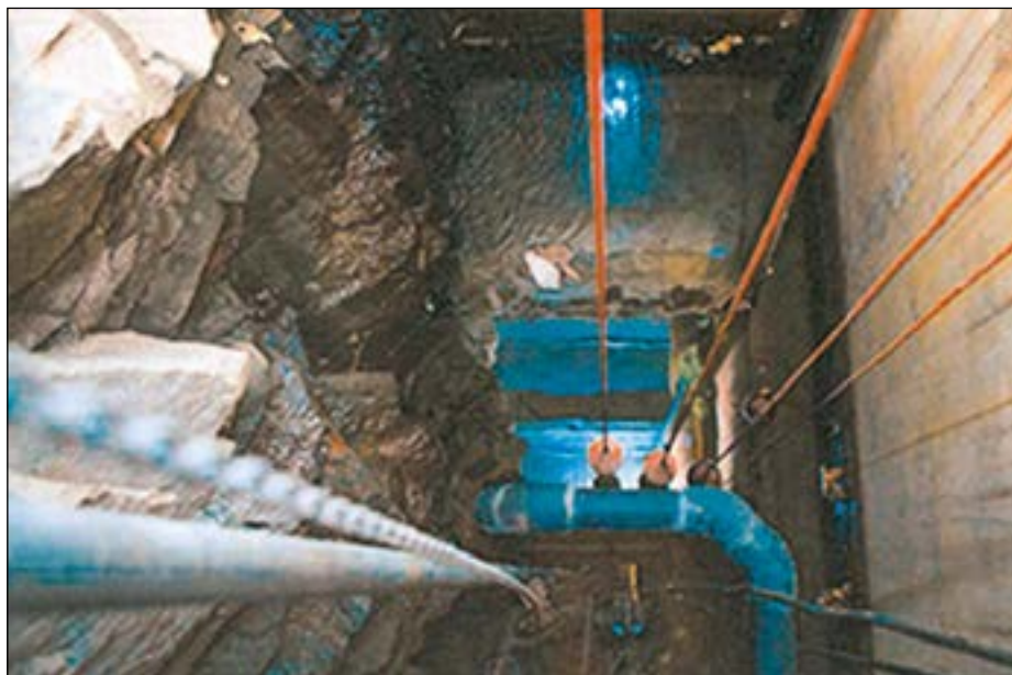
Grunnvannet under Asker kulturhus holder en temperatur på minimum 8 grader.
