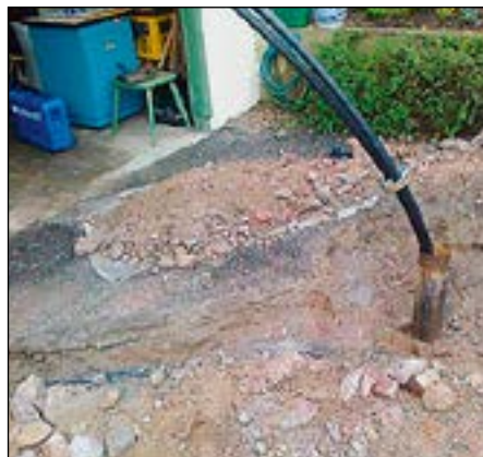
Bergvarmepumpen er et billig, bekvemt og vedlikeholdsfritt oppvarmningssystem.
