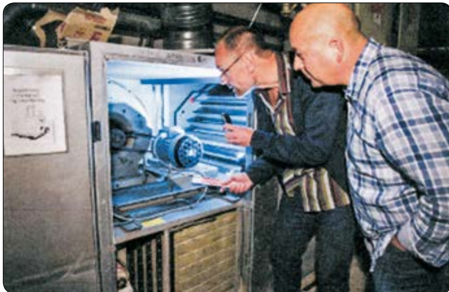
Niels Knokgård og Jens Hedegaard mener at 70 procent af den samlede masse af ventilationsanlæg i Danmark med fordel kan energirenoveres.
