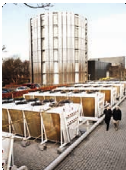
DTUs tørkølere, der producerer fjernkøl svarende til kølingen af ca. 35.000 hus-holdningskøleskabe.
