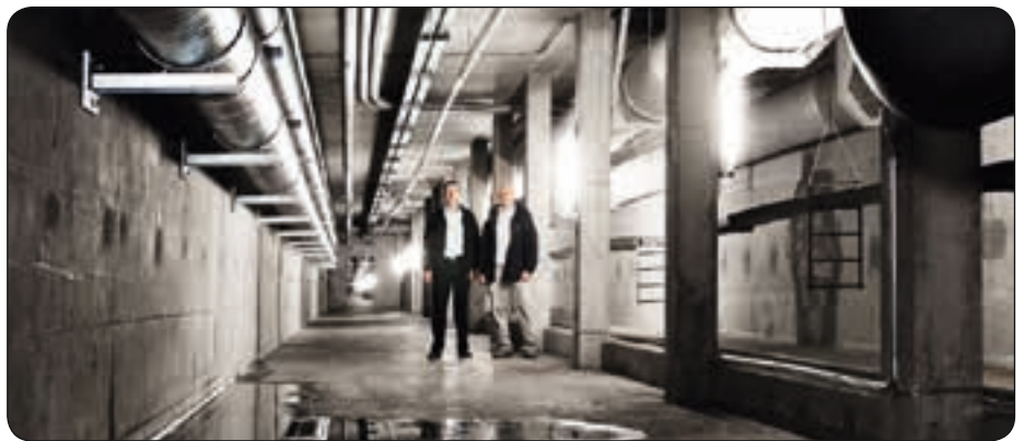
Steen Hansen fra DTU og Laurids Finnemann fra ALECTIA er på inspektion i en af de mange underjordiske gange med i alt 8,2 km fjernkølingsrør på DTU, der forsyner DTUs mange serverrum og procesanlæg med klimavenlig fjernkøl.
