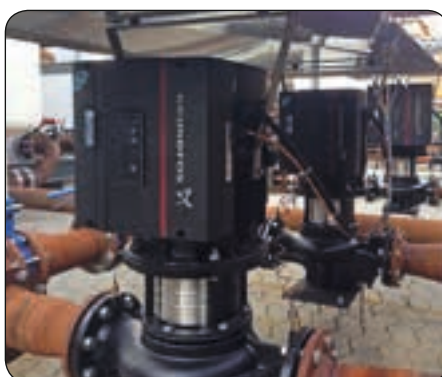
På en stenbelagt plads på DTU Risø Campus står der nogle beskedne grå teknikhuse. Der gemmer én af Danmarks kraftigste supercomputere. Og det er pumper fra Grundfos, der søger for at køle supercomputeren.
