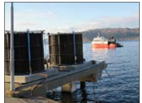
I sjøen utenfor Strand skole på Hitra er det plassert to trommelkollektorer som hver inneholder 4 600 meter med rør.
