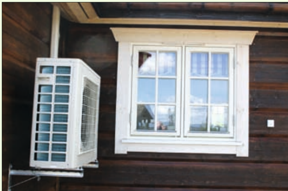
En varmepumpe er vel ikke spesielt vakker på en fjellhytte, men den skal kles inn med samme panel som veggen. Det er for øvrig viktig at man ikke bygger slik at luftstrømningen gjennom varmepumpen ikke hindres.
