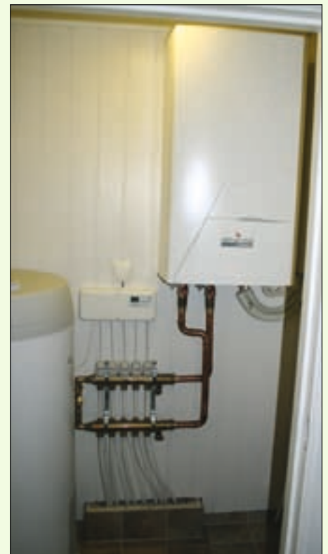
Varmepumpen og fordelingscentralen ble installert i et eget rom sammen med varmtvannsberederen.
