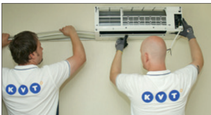
Her monteres varmepumpen av serviceleder Rune Samuelsen og servicetekniker Morten Olsen fra Klima & Varmeteknikk. (Foto: Jan H. Kalvik)
