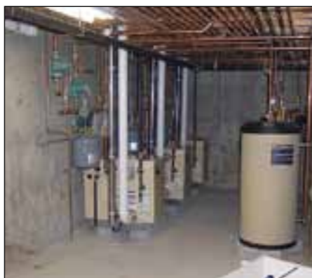
De fleste oljefyrte anlegg i villabebyggelse kan med små inngrep erstattes med mer miljøvennlige alternativer.
