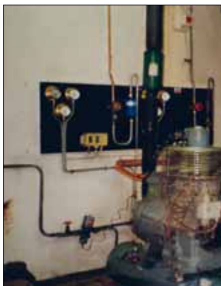
De siste decennier har det skjedd en rivende utvikling på kjølefronten. Dette krever helt nye og oppdaterte kunnskaper.
