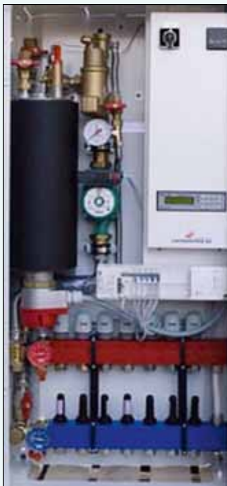
Alt i en boks. Varmepumpe, elektrocentral, varme- og sanitærsentral og inkludert varmtvannsbereider og akkumulatortank.
