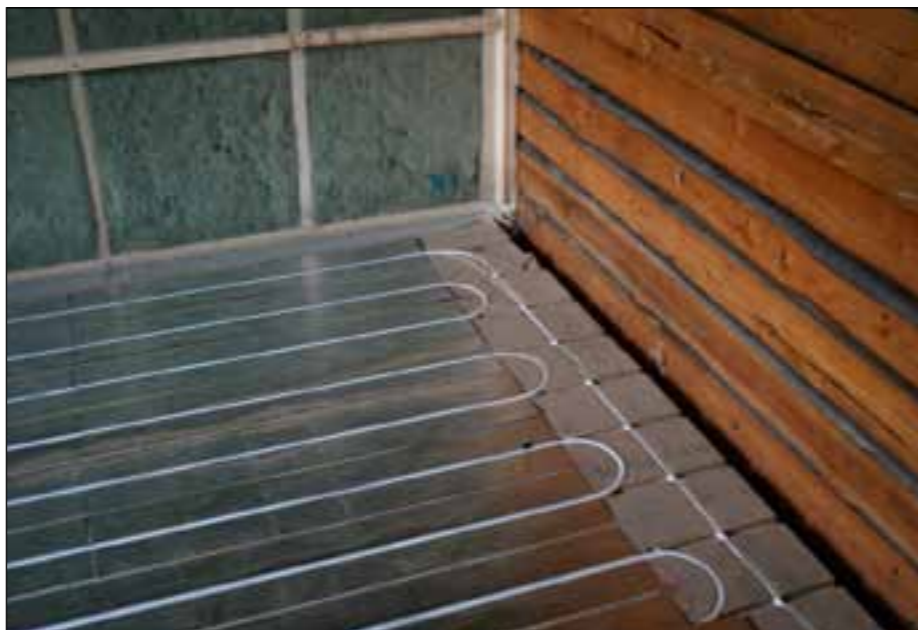
Vannbåren varme er derfor en joker for å få til et fleksibelt energisystem med f.eks. varmepumper.
