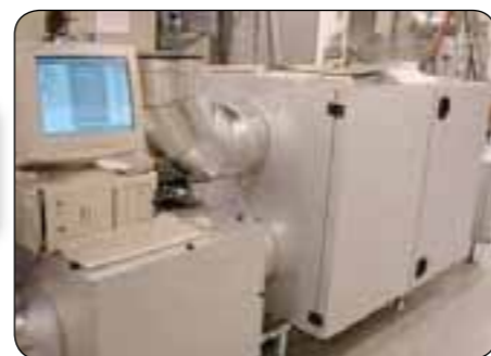
Varme- ventilations- og airconditioningsystem, opstillet hos Teknologisk Institut i Taastrup. Anlægget er koblet til internettet og kan styres fra Aalborg Universitet.
