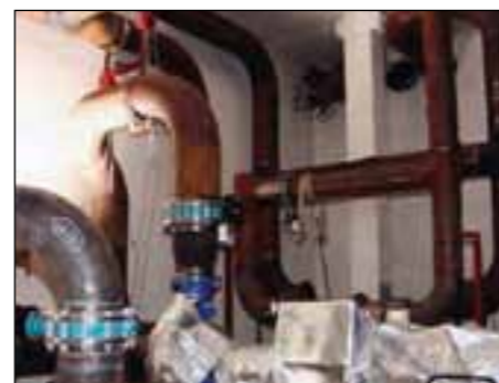
Fra energisentralen i kjeller på det nye Scandic hotell.
