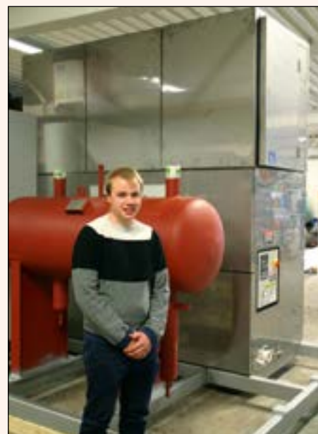
Kim Johansen foran ismaskinen han er i ferd med å bygge opp basert på prefabrikkerte elementer.
