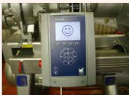
Elektronisk overvåkning og frekvensstyring av kompressoren gir full oversikt og gir energibesparelser og bedre miljø.
