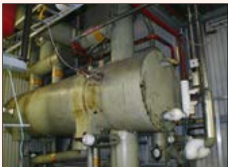
Den gamle væskeutskilleren fra Kværner Kulde har gjort jobben sin.
