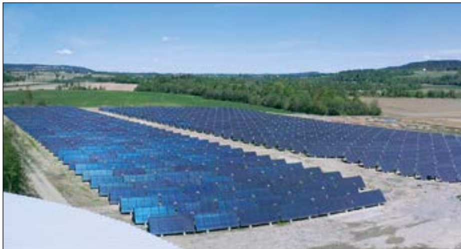
Solfangeranlegget to kilometer nord for Lillestrøm dekker et område på 12 800 kvadratmeter og skal dekke varmebehovet til over 250 husstander. Foto: Akershus Energi.
