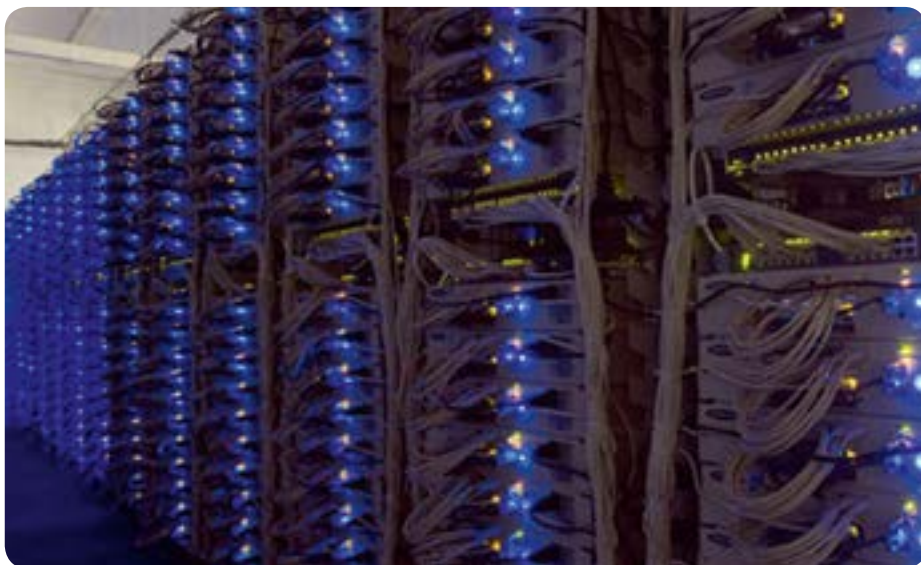
De store it-giganter eksperimenterer med innovative kølemetoder til deres datacentre.
