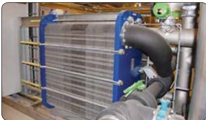
Det afkølede vand fra varmeveksleren cirkuleres rundt i bygningen for at køle værelserne til den ønskede temperatur. Ingen aktiv køling er påkrævet.
