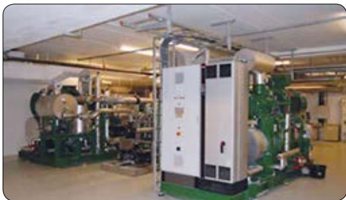
To 355 kW VLT® HVAC Drives FC 102 IP 54 frekvensomformere styrer skruekompressorerne, som gør det muligt for de to GEA Greenco varmepumper, på 2400 kW, at justerer varmen fra lav til høj præstation med den samme effektivitet.
