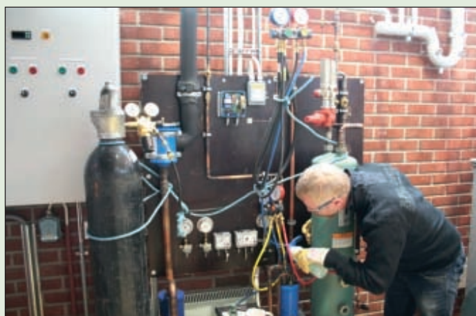
Etter at anlegget er styrkeprøvd kan det tetthetsprøves med trykk opp mot PS. Prøv å unngå å benytte utstyr hvor det har lett for å oppstå lekkasje.
