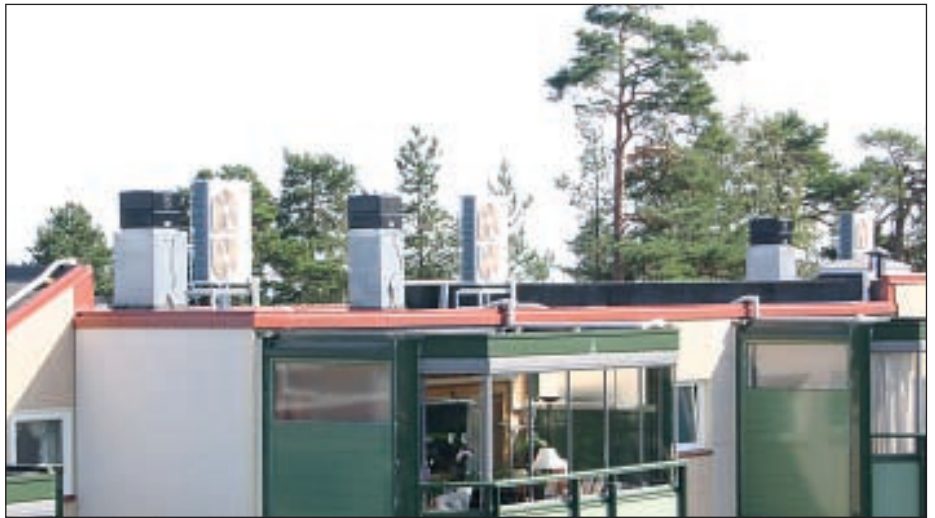
Varmepumpene er plassert tilbaketrukket på det flate taket for å skjule både varme-pumpene og rørforingen fra dem.. Plasseringen på taket forhindre også hærverk.
