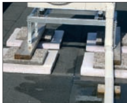
Varmepumpene er skikkelig opplagret for å unngå vibrasjonsstøy.
