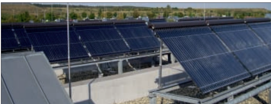
Solkollektorer og solfangere i kombinasjon med varmepumper kommer til å bli mer brukt i fremtiden.
