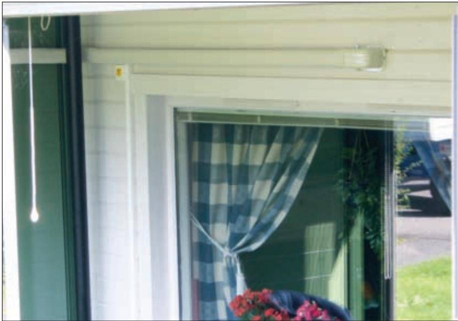
Tilførselrørene er diskret skjult på veggen på de forskjellige verandaene.
